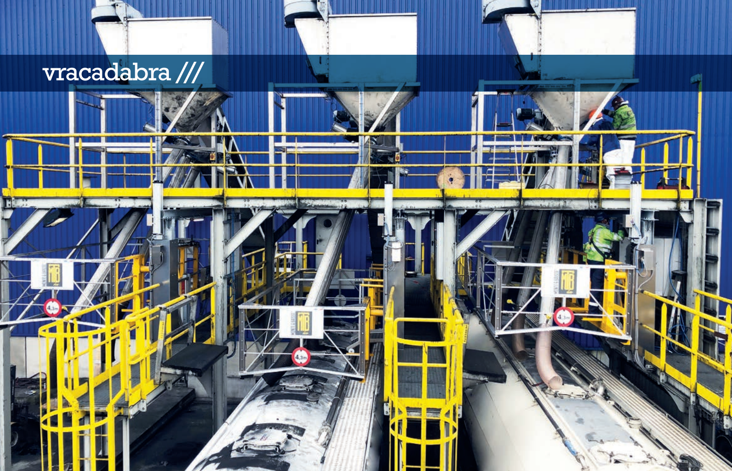
Montage sur site complet (pistes 1, 2 et 3).
