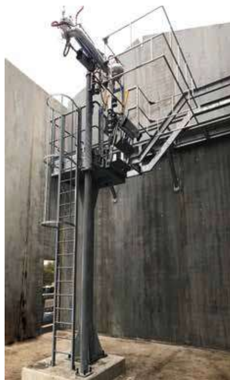
L'ensemble bras de chargement et passerelle à abattant installé sur site.
